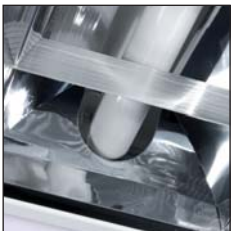
■ päťce žiarivkových trubíc zakryté reflektorom
