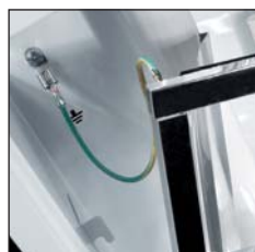
■ ochranný vodič pripojený k mriežke slúži k ochrane pred úrazom elektrickým prúdom
